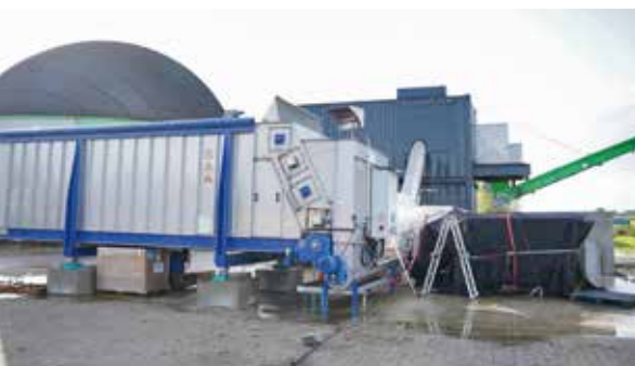
Proteingewinnungsanlage auf dem Betrieb Geil
